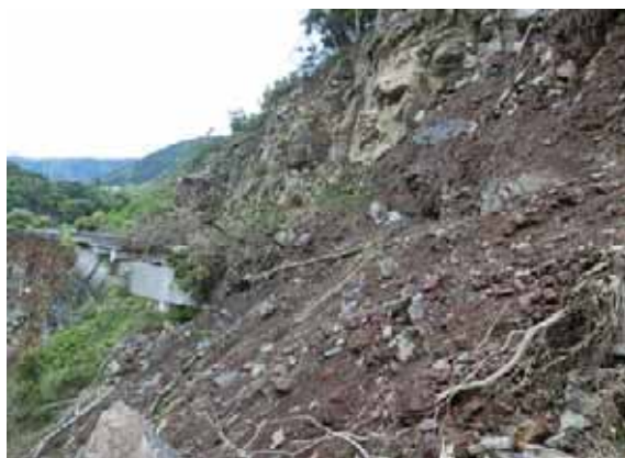
写真-3 岩盤崩落と戸下大橋の落橋
