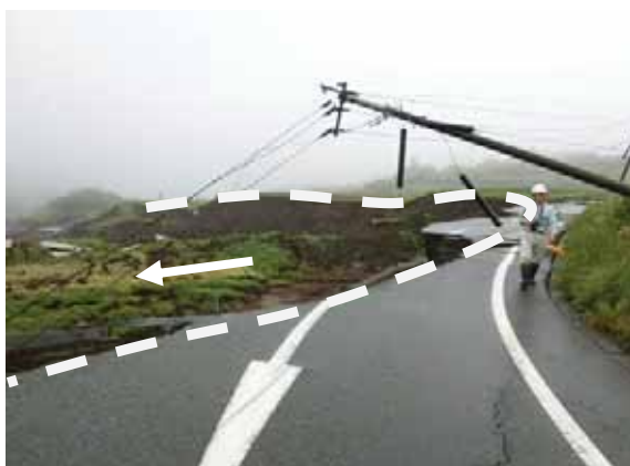
写真-4 地すべり冠頭部の村道被災状況
