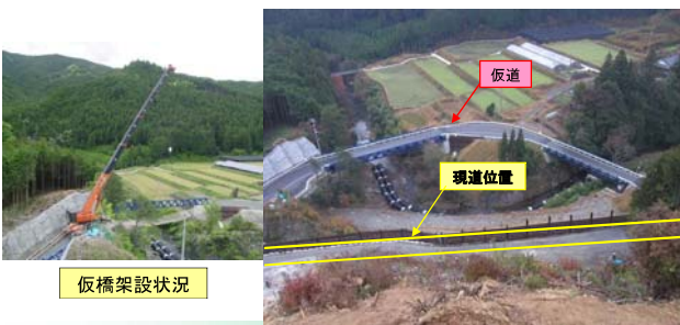
愛媛県久万高原町／(国)380号道路災害復旧工事
